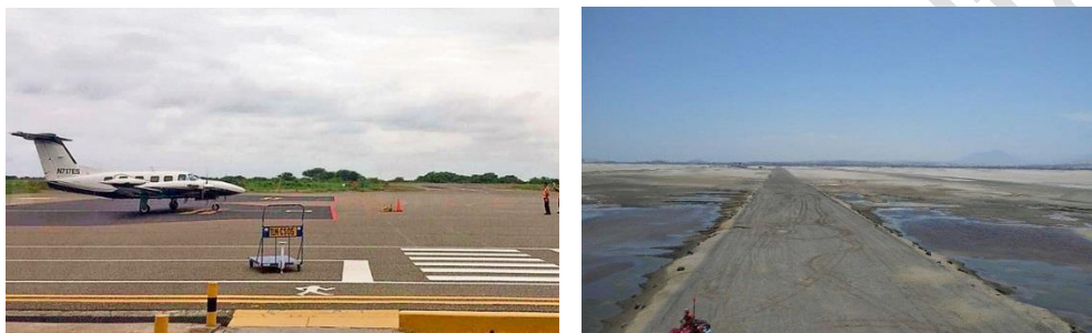
Foto 23. Izquierda: Aeropuerto Teniente FAP Jaime Montreuil Morales. Derecha: Pista de aterrizaje con filtraciones de aguas subterráneas producidas por la irrigación del PE Chincas
